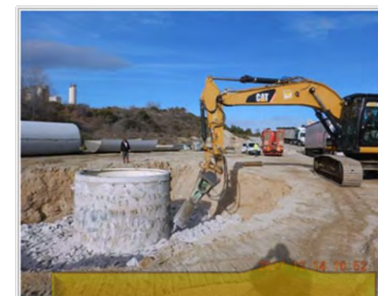
Destruction des fondations
