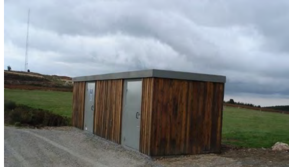
Figure 11 : Exemple de poste de livraison avec bardage en bois, parc éolien du Margnès (81) (Source : VALECO Ingénierie)
